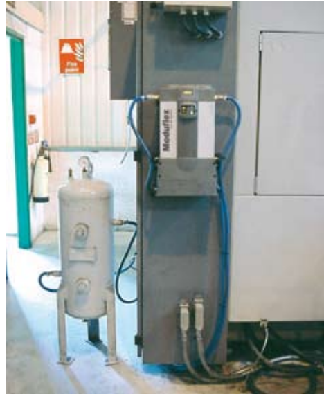
Moduflex Drucklufttrockner für die Steuerluft einer CNC-Drehmaschine
